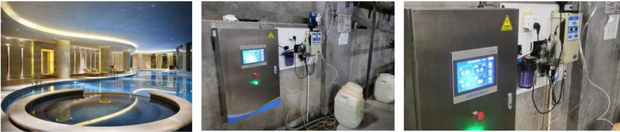
监测参数:余氯、pH、水温、浊度 仪器:多参数在线水质监测仪
