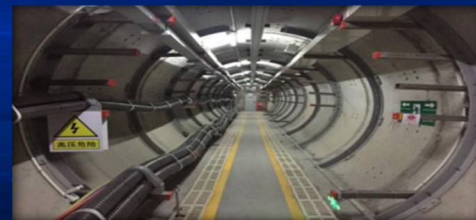
管廊安全状态监测
