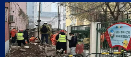
热力安全：2022.11.20，北京朝阳区一地下室供暖水泄漏，造成2人死亡。
