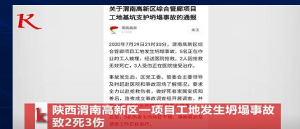
综合管廊：2020.7.29，陕西渭南高新区综合管廊项目工地发生坍塌事故，5名正在作业的工人被埋。
